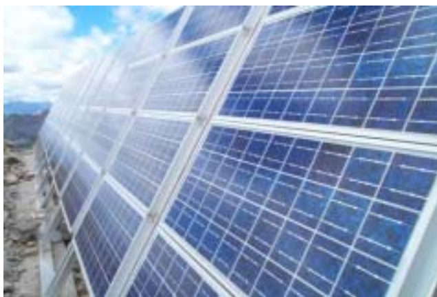
Panneaux photo-voltaïques assurant l'alimentation électrique de la station
