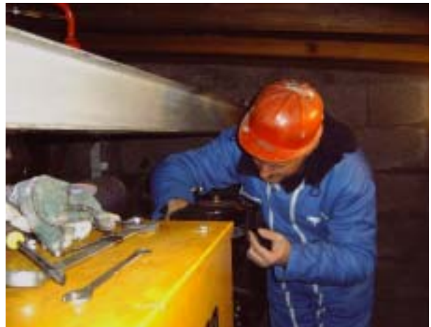
Démarrage un peu laborieux du groupe 7,5 kVA à cause de la présence de glace dans les durites d'alimentation en gas-oil du moteur.
