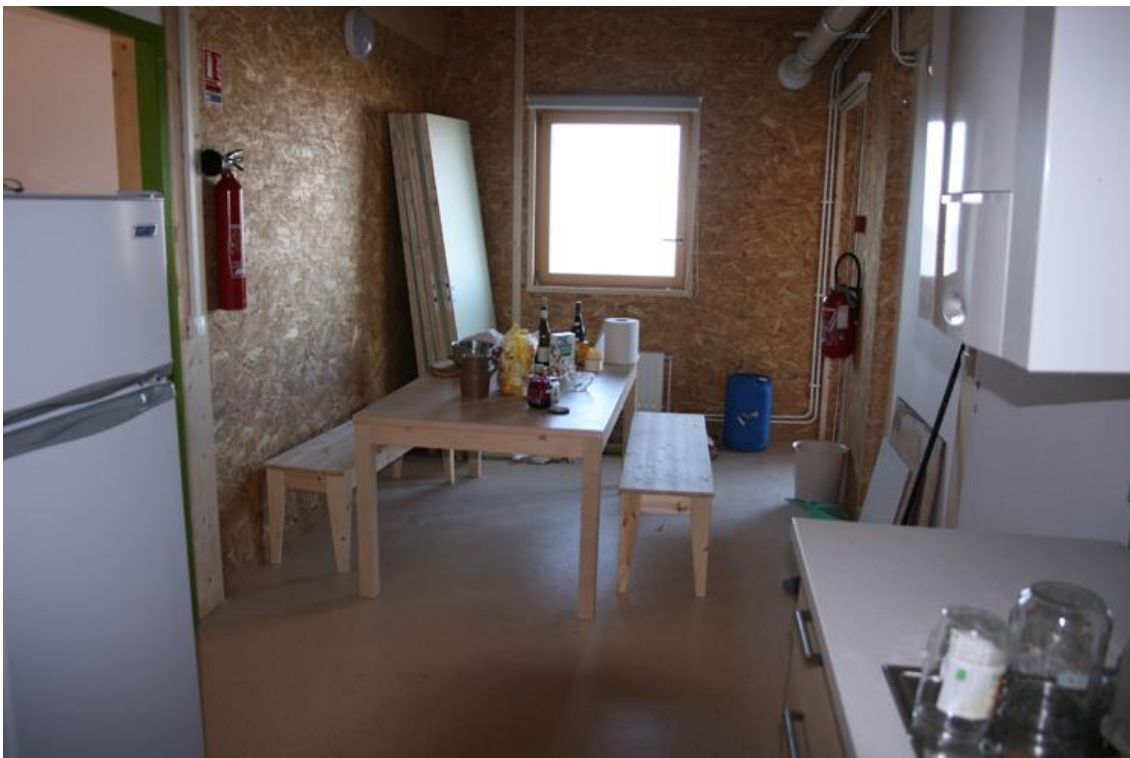
Cuisine Astroqueyras : deux extincteurs ; un de classe B (à gauche) et un autre de classe ABC (à droite)
