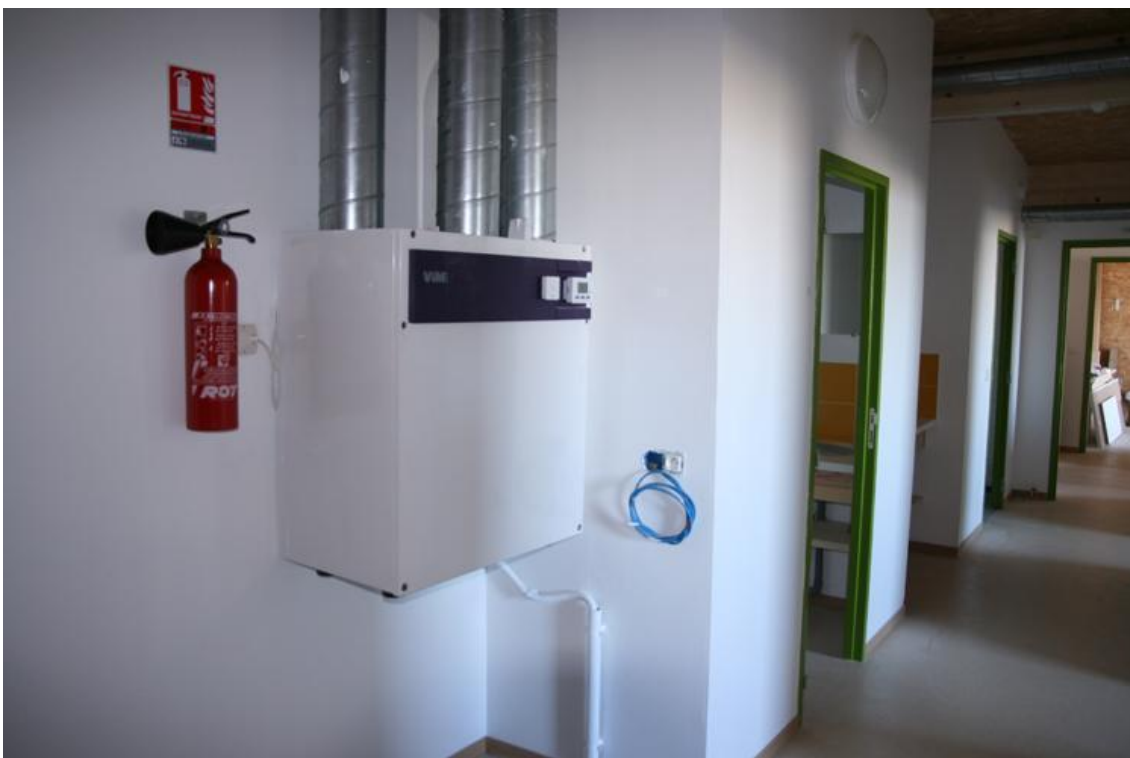
Couloir visiteur (près VMC) : un extincteur de classe B
