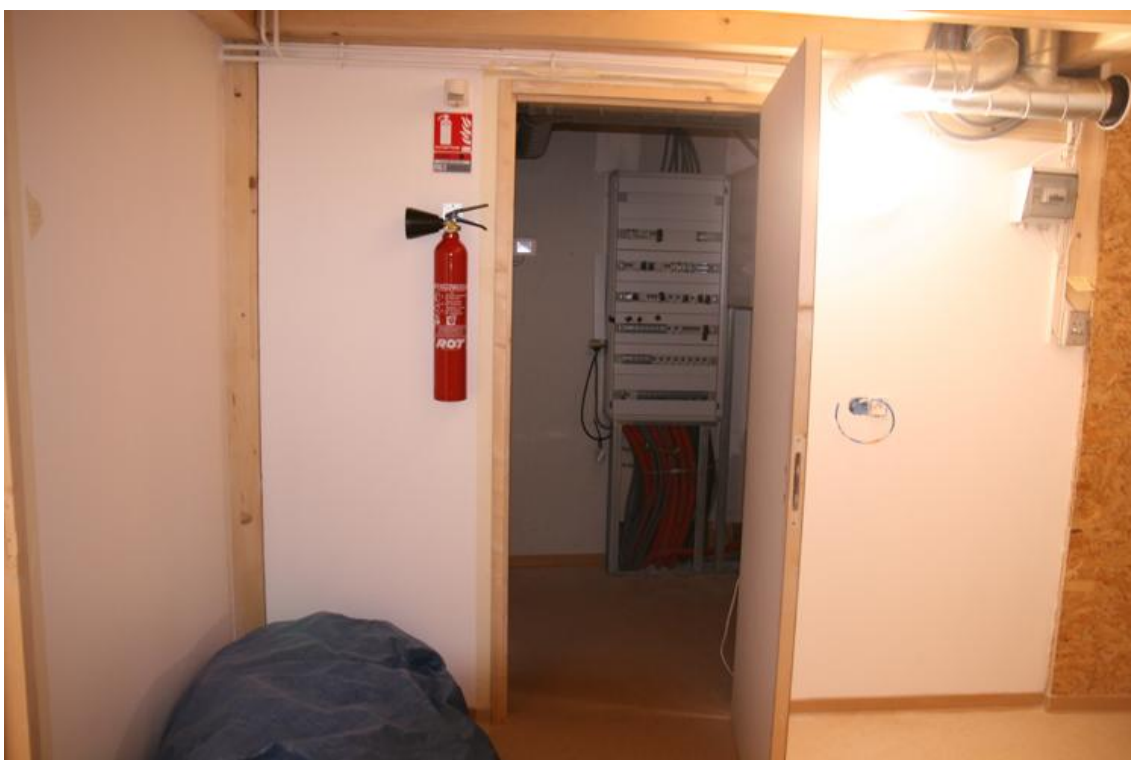
Entrée local technique : un extincteur de classe B
