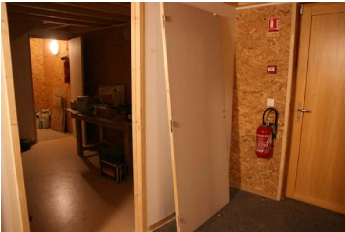
Entrée Astroqueyras (futur atelier à gauche sur la photo) : un extincteur de classe ABC
