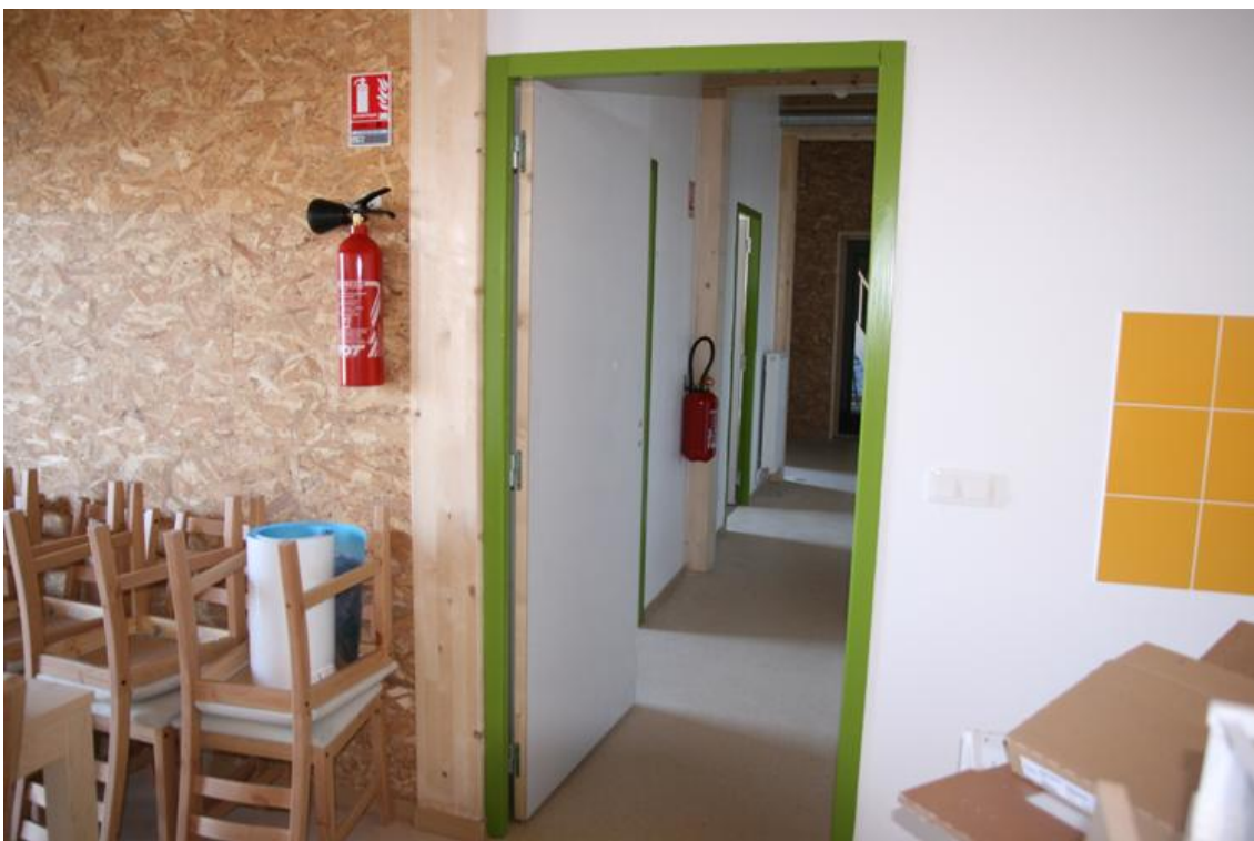
Cuisine visiteurs : un extincteur de classe B
